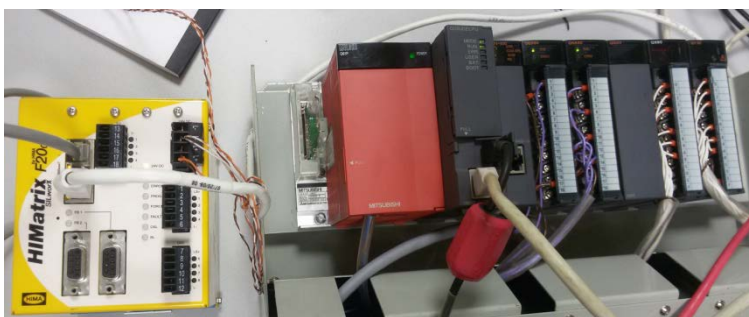
Рисунок 1-Испытательный стенд демо-оборудования на базе HIMatrix F20 и Mitsubishi Electric Q03
